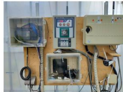
データロガーで 温度・湿度・日照量・電力消費量のモニタリング
